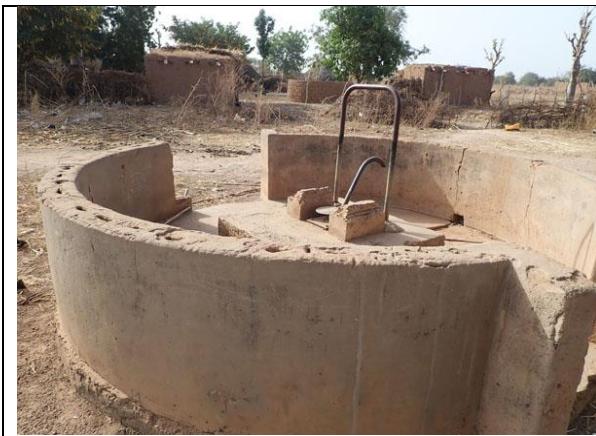
Photo 17 : Forage PMH non fonctionnel à Reggi Farrey
