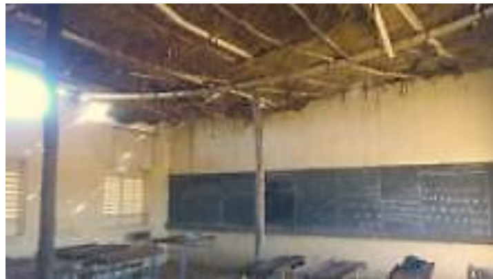
Photo 13 : Etat d'une salle de classe à LoufariKoira avec la toiture en paille
