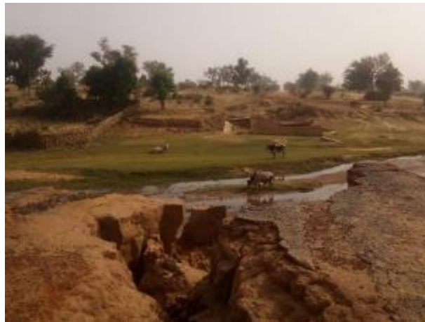
Photo 10 : Aperçu de la RN35 complètement détruite entre Margou et Gobéri
