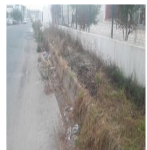
Caniveau obstrués par la végétation
