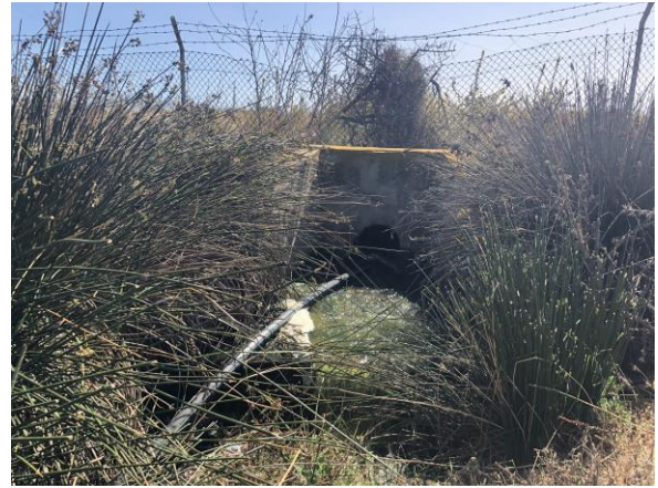
Point de rejet de la STEP de Bouznika
