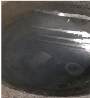
Accumulation de débris à l'intérieur des regards
