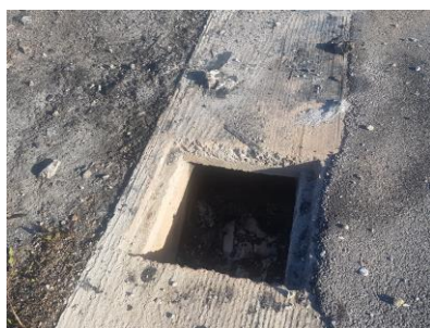
Caniveau obstrués par les déchets
