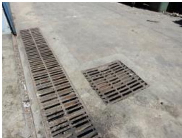
Figure 3-8 Regards d'eau pluviale présents dans le CTRD
