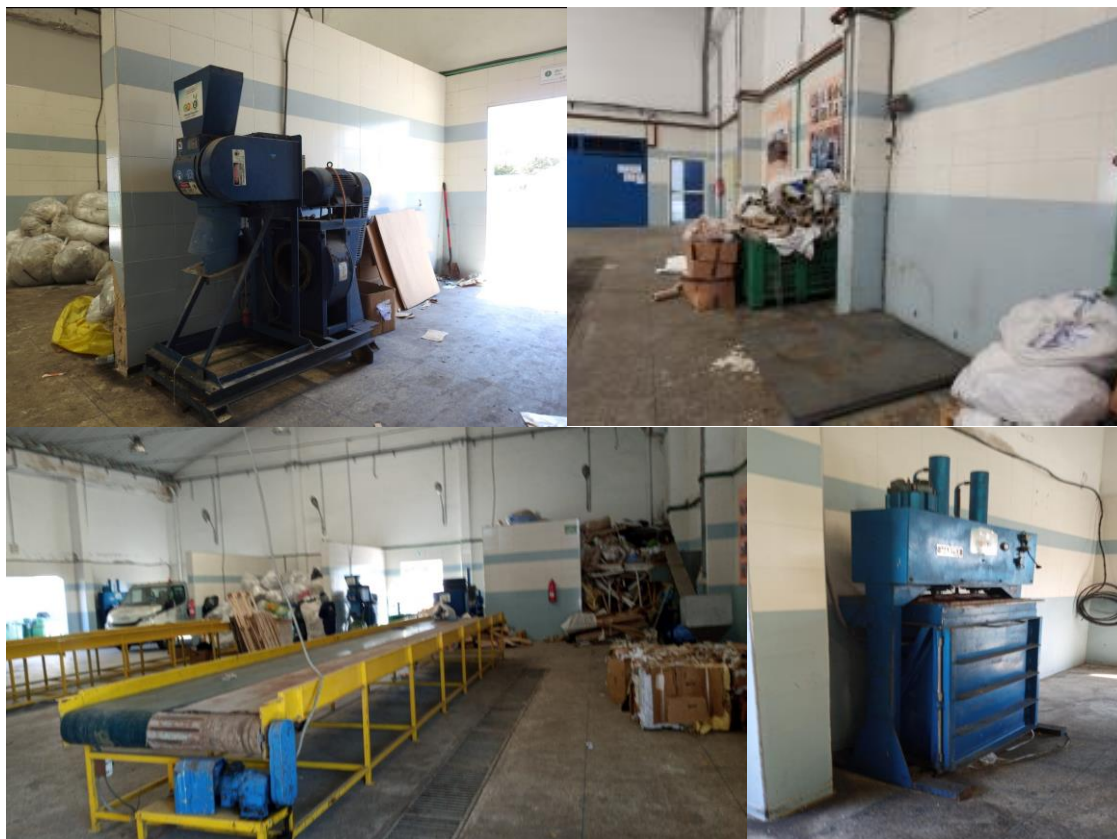
Figure 3-3 Equipements existants au CTRD
