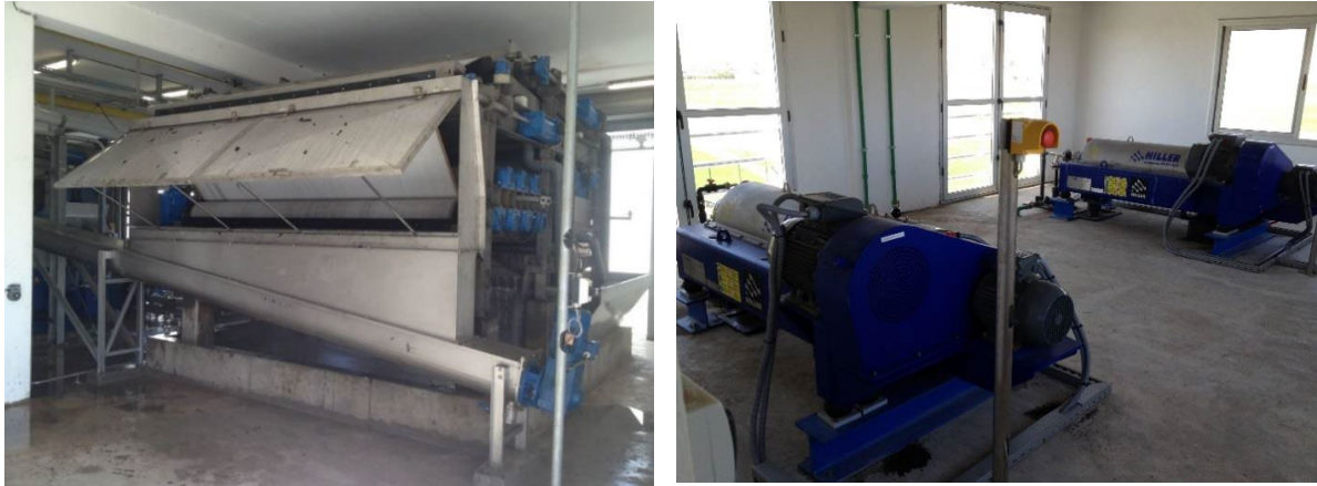
Figure 3-15 : Déshydratation des boues
