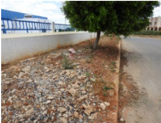
Vue de la ZI: Etat de la chaussé
