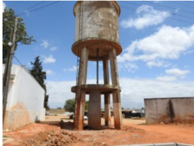
Château d'eau à proximité de la commune qui alimentant les riverains
