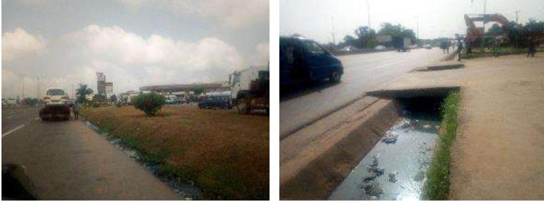
Figure 142 : Vues d'ordures ménagères et eaux usées dans les caniveaux de l'aire d'étude de Yopougon Express (source : Egis, 2020)
